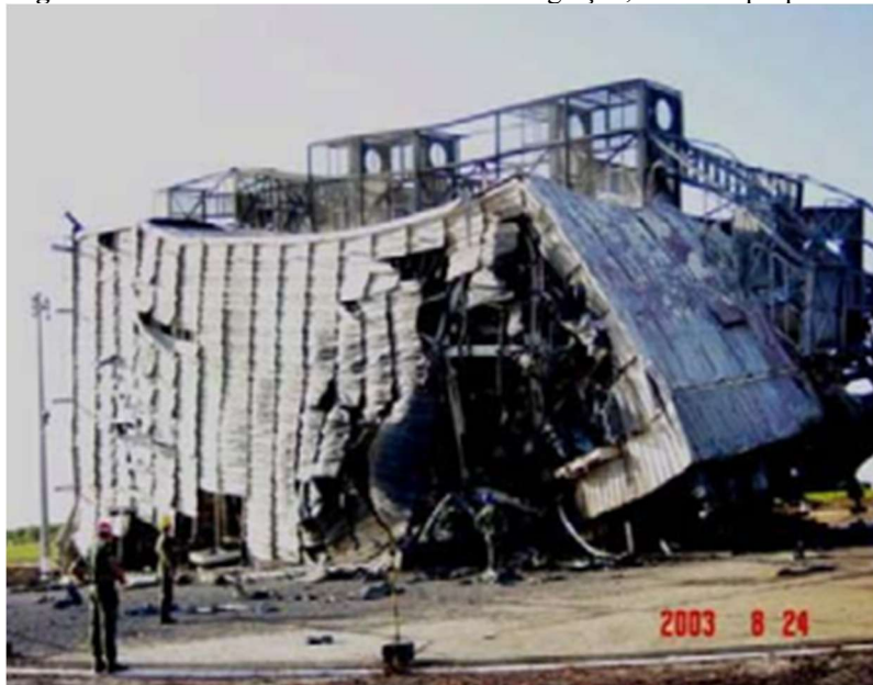
Figura 4 - Vista lateral da torre móvel de integração, lado dos propulsores C e D.
