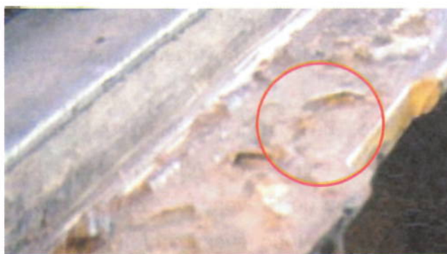
Figura 4: Corrosão por desfolhamento em estrutura de alumínio. Fonte: PAMA-GL.
