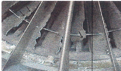
Figura 24: Danos à turbina Fonte: www.fodnews.com
