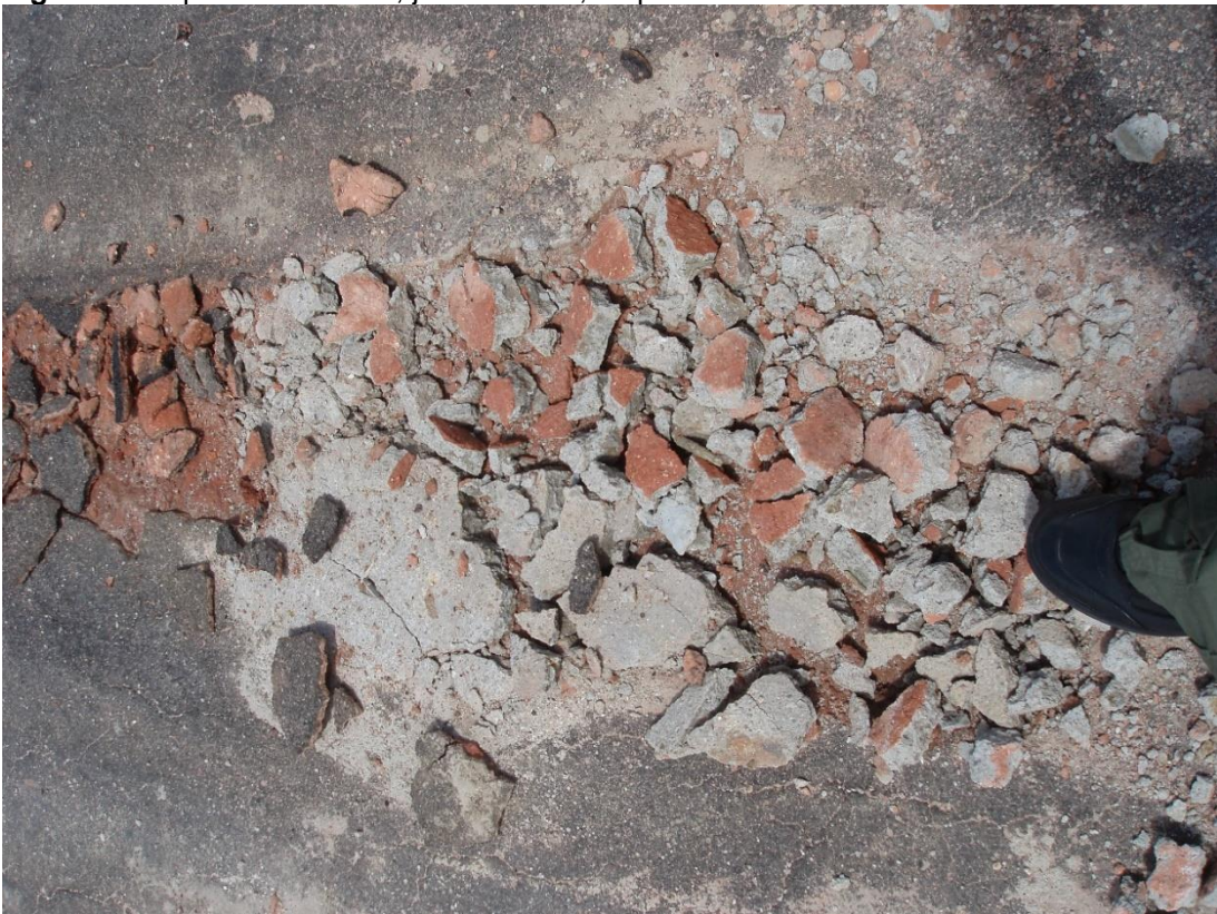
Figura 5 - Reparo de cimento, já danificado, na pista de Surucucu-RR. Foto de 2011.
